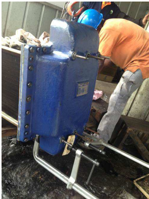
Air Cooler 試壓夾法
