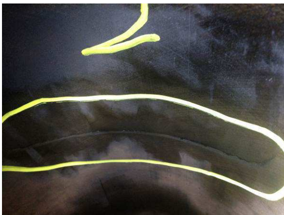
Liner 內部裂痕
