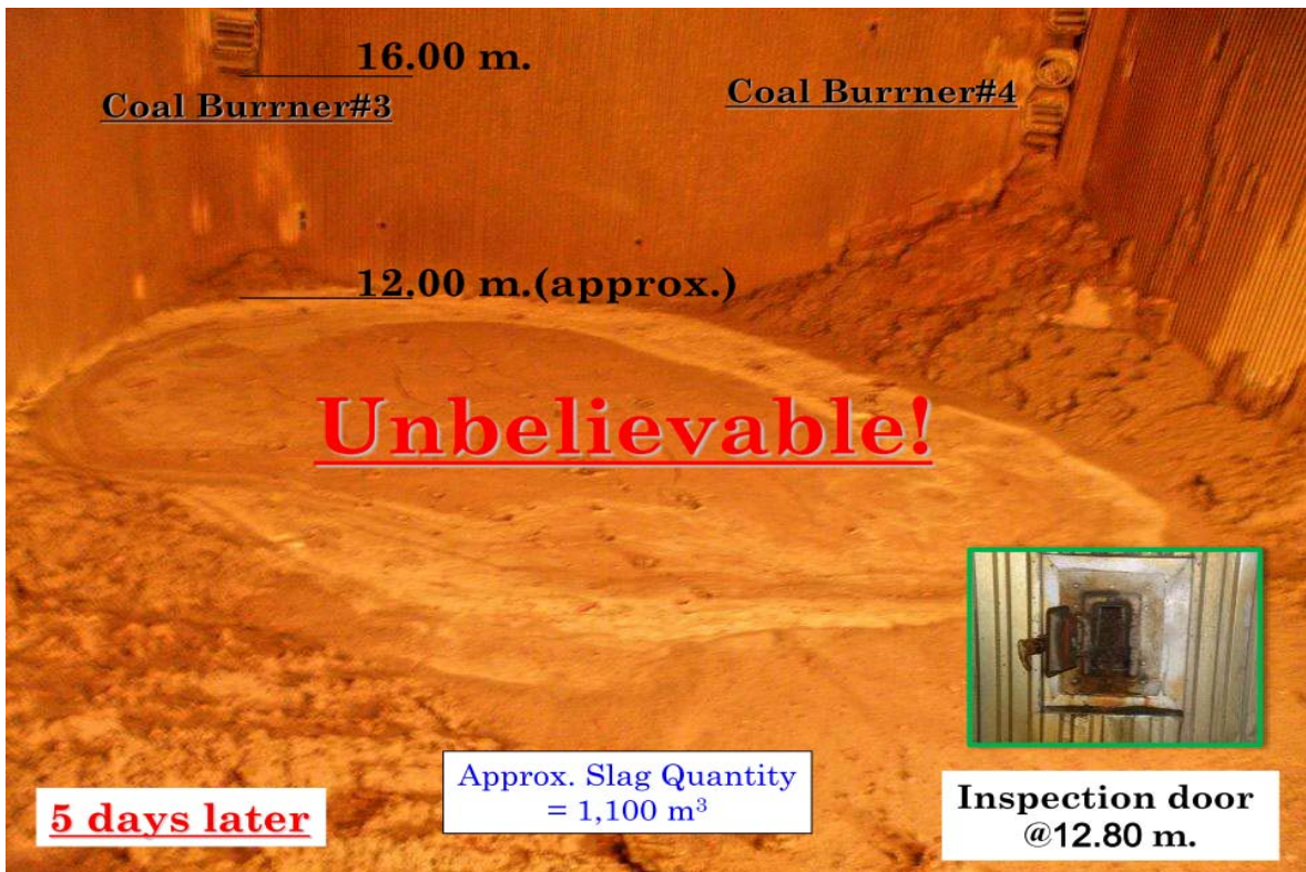
令人難以置信！經5天後結渣至12米高 #3、4燃燒器有16米高，在12.80米檢查門看，估計渣數量有1100立方米
