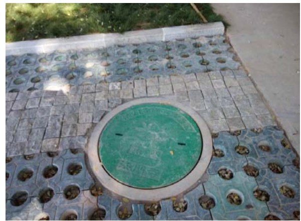
照片 21 雨水下水道人孔蓋設於停車格上
