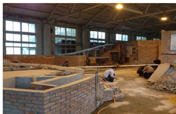
照片 17 室内水工试验室
