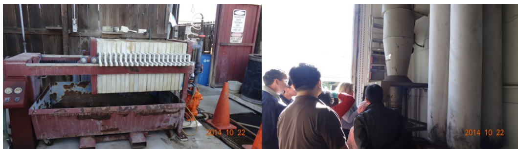
圖 22、查核廢水污泥脫水機（左）及空氣污染防治設備（右）
