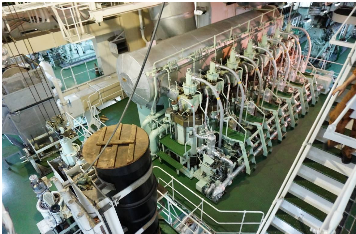
圖 14 機艙控制室主機
