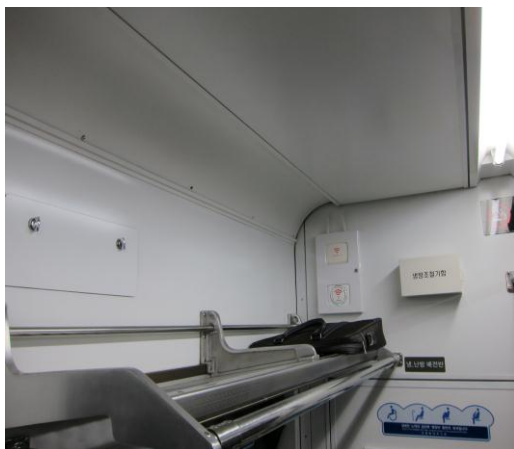
首爾地鐵 9 號線車內 WiFi 設備
