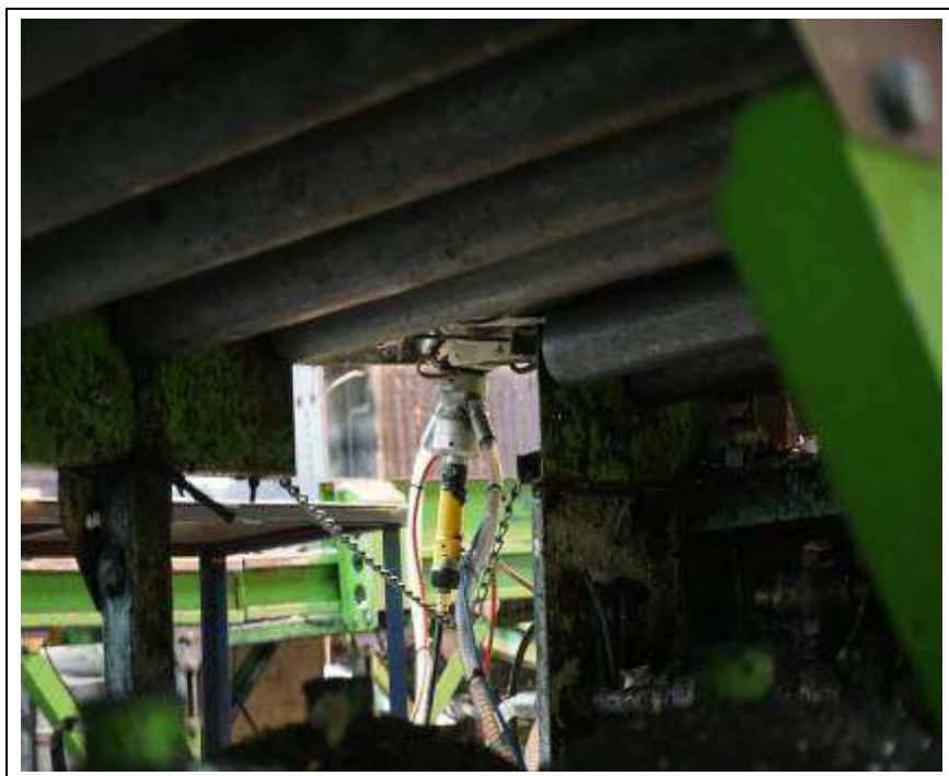
圖 6 廢電冰箱回收壓縮機冷媒與冷凍油之處理設備
