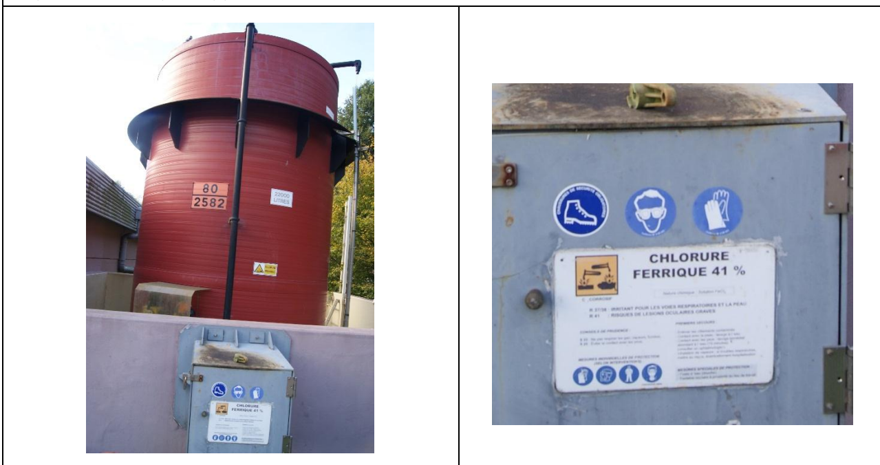
濃度 41%之氯化鐵貯藥桶槽
