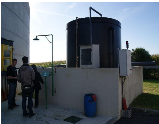
氯化鐵藥品貯放桶槽及防溢堤
