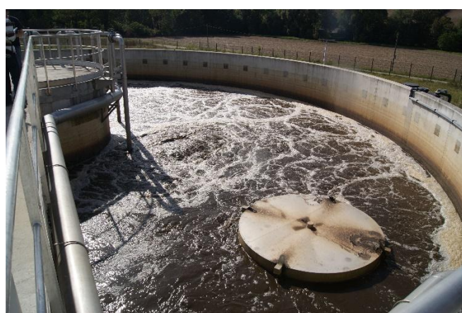
生物活性污泥曝氣池
