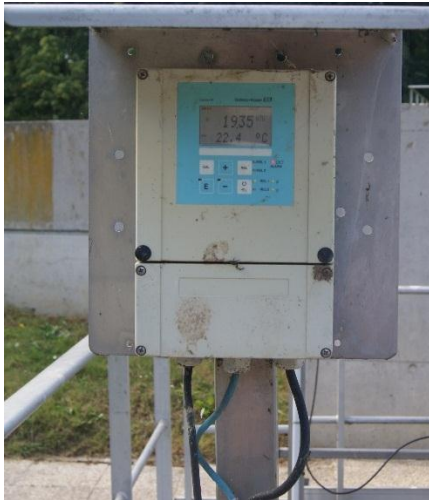
放流水線上水質監測儀器(濁度、水溫)
