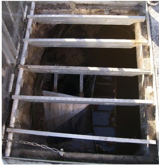
氣曝浮除刮脂機
