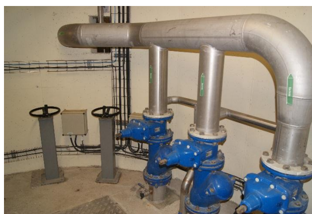
污水進流抽水幫浦
