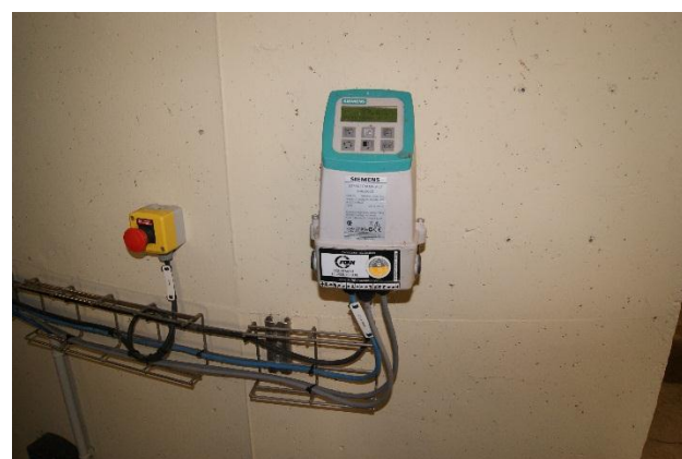
污水進流流量計
