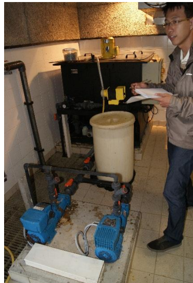
高分子凝聚劑加藥設備
