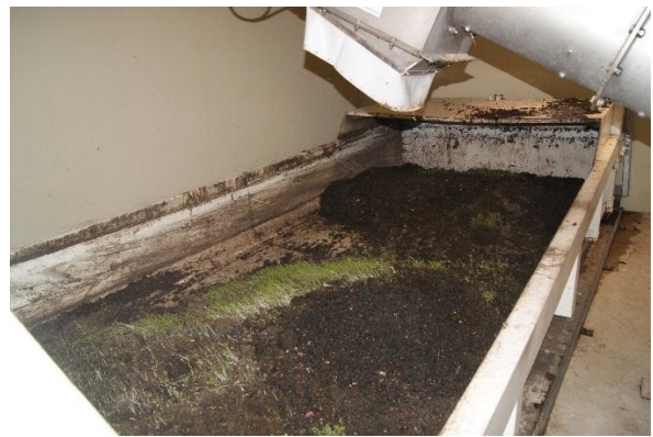
固液分離沉砂機(三)分離之砂礫
