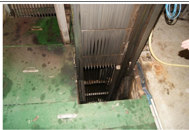
污水進流攔污柵
