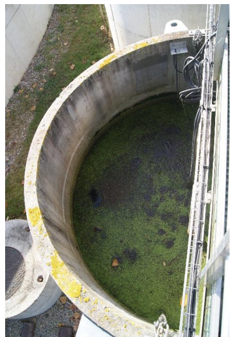
污泥濃縮調節池(緩衝調節迴流池)
