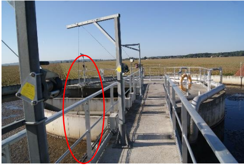
活性污泥池自動控制污泥進流閘門
