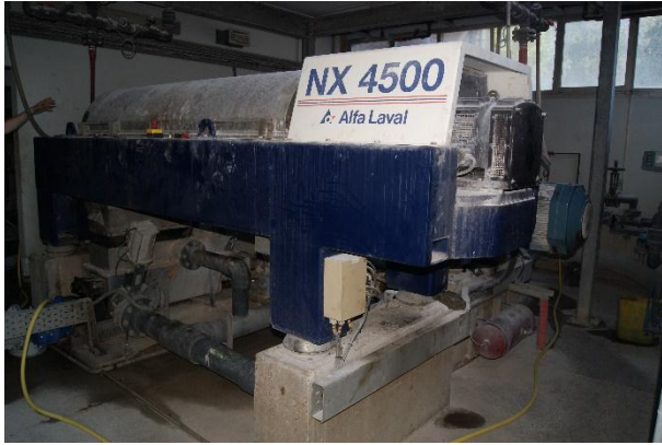
污泥固液分離離心脫水機
