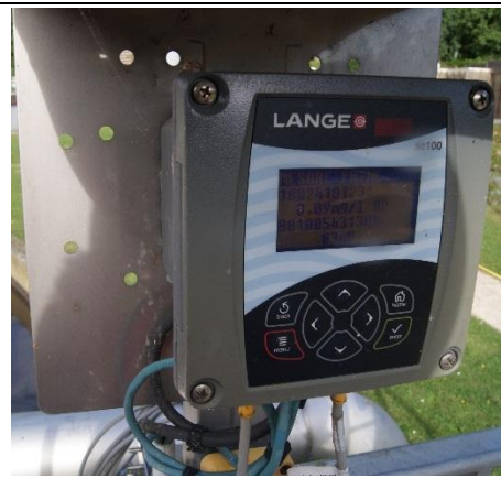
活性污泥曝氣池重要線上監測參數(溶氧)
