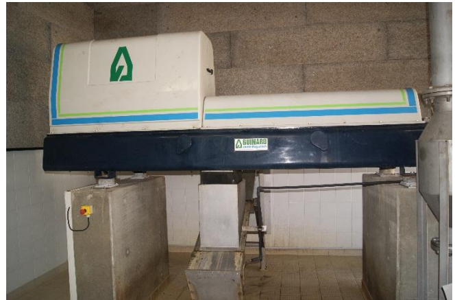
污泥固液分離離心脫水機
