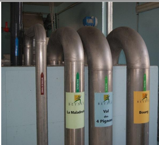
輸送管線清楚標示便於操作維護
