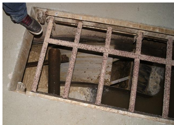
氣曝浮除沉砂刮脂設備
