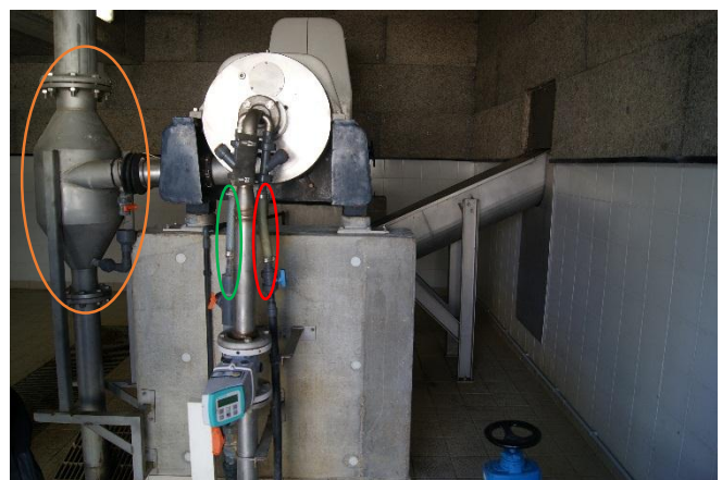
橘色：混合攪拌進料處；紅色：高分子凝聚劑加藥管；綠色：清水添加管
