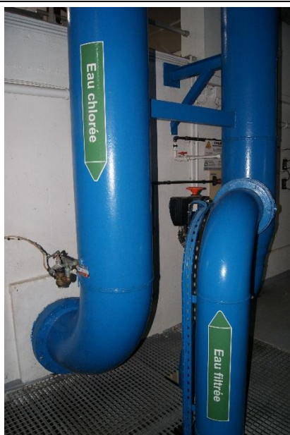
管線流向名稱標示清楚分明 (左：加氯水；右：過濾水)
