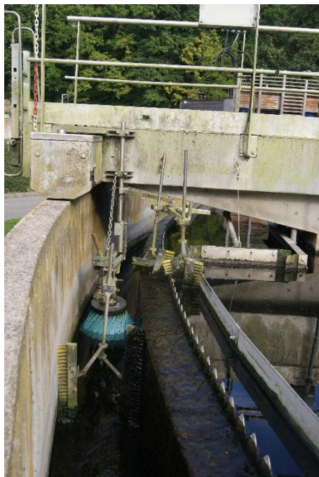
終沉池自動清洗池壁及溢流堰設備
