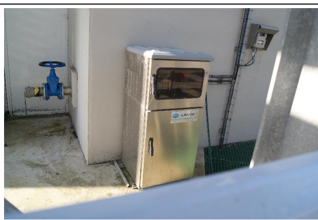
逕流排放放流水自動採樣器
