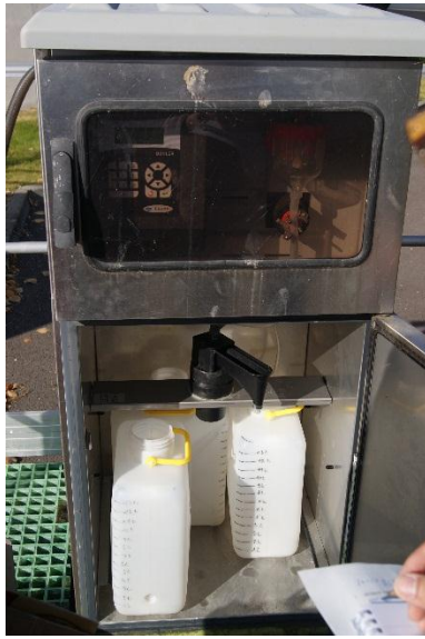
放流水自動採樣設備
