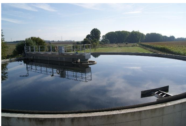
污泥最終沉澱池
