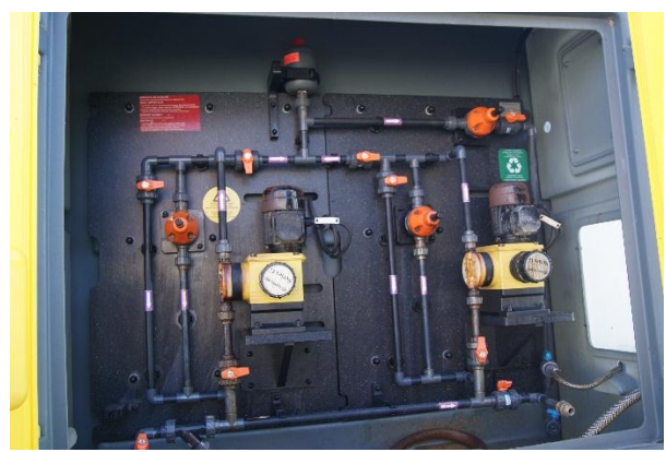
氯化鐵加藥設備
