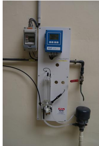
清水線上監測殘餘臭氧儀器
