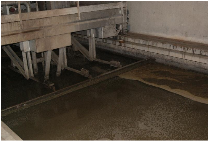
浮除沉砂刮脂機
