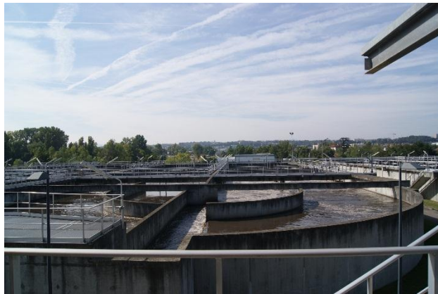
生物活性污泥曝氣池
