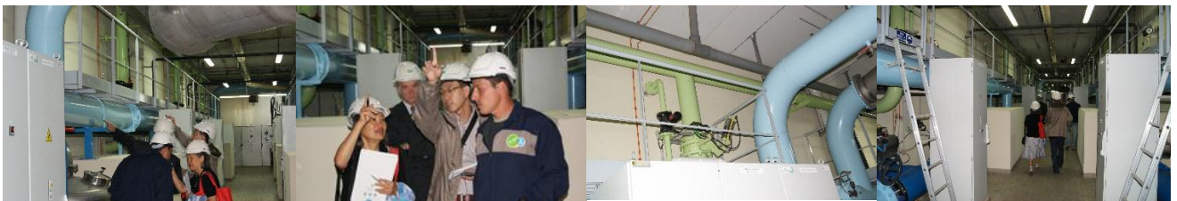
管線規劃整齊用顏色區分便於管理操作維護
