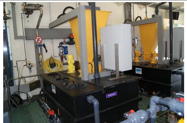
助凝劑泡藥預處理設備
