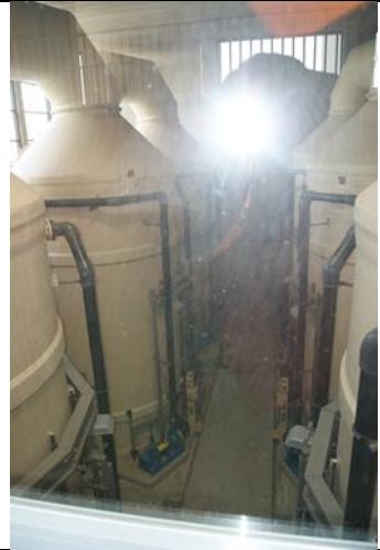
除臭濕式洗滌塔
