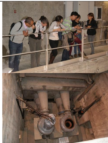
進水抽水幫浦(右：維護中)
