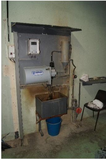
原水線上監測濁度計
