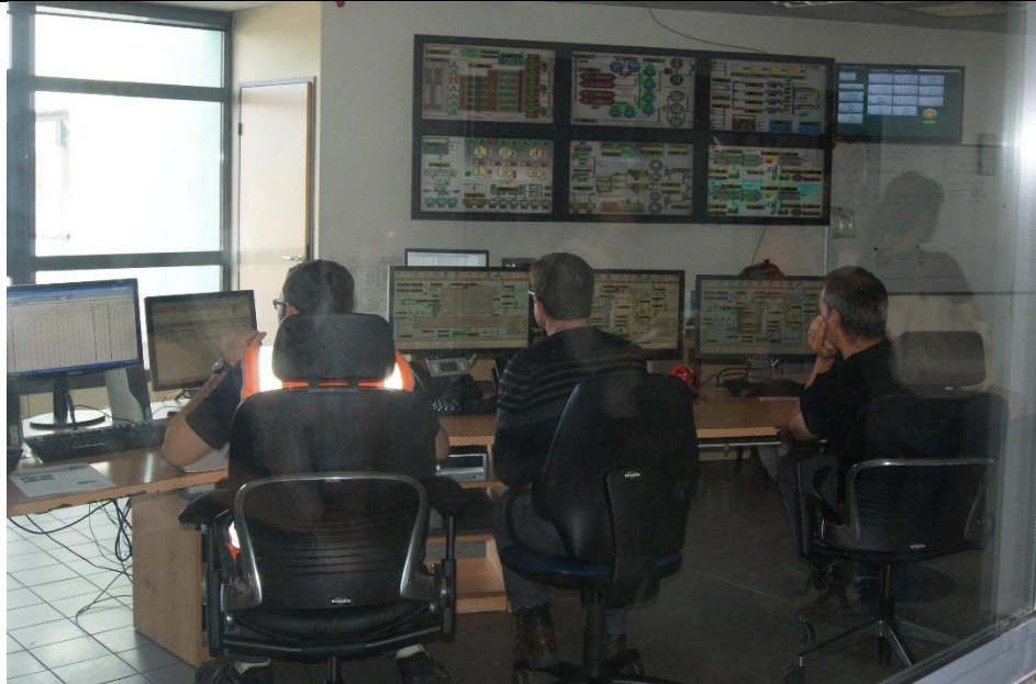
Pierre-Bénite 污水處理場中控室
