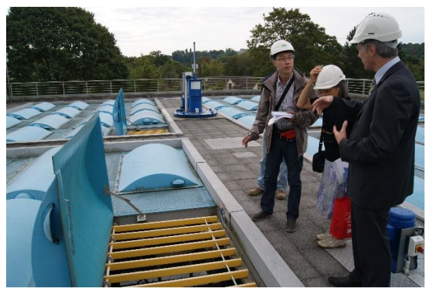
高速膠羽沉澱池(Densadeg 專利技術，目的增加 floc 大小以利沉降)
