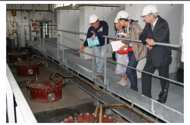
四台大型原水抽水機
