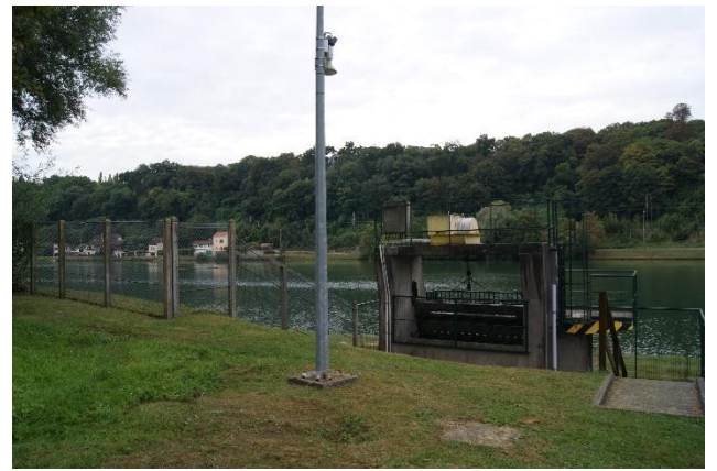
取水口(原水水源取自塞納河)
