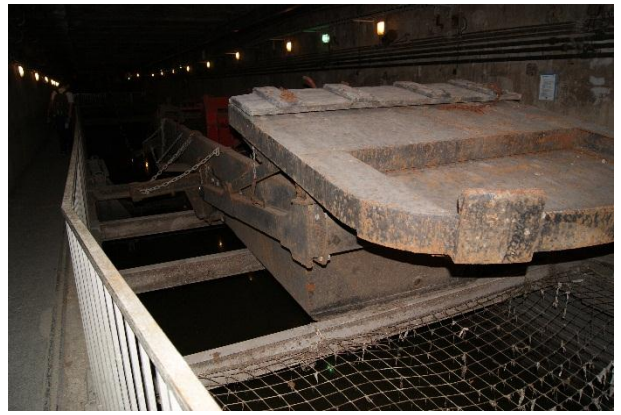
下水道污水收集匯流處
