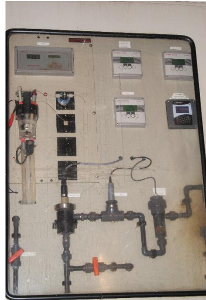
污水線上水質監測儀器配置
