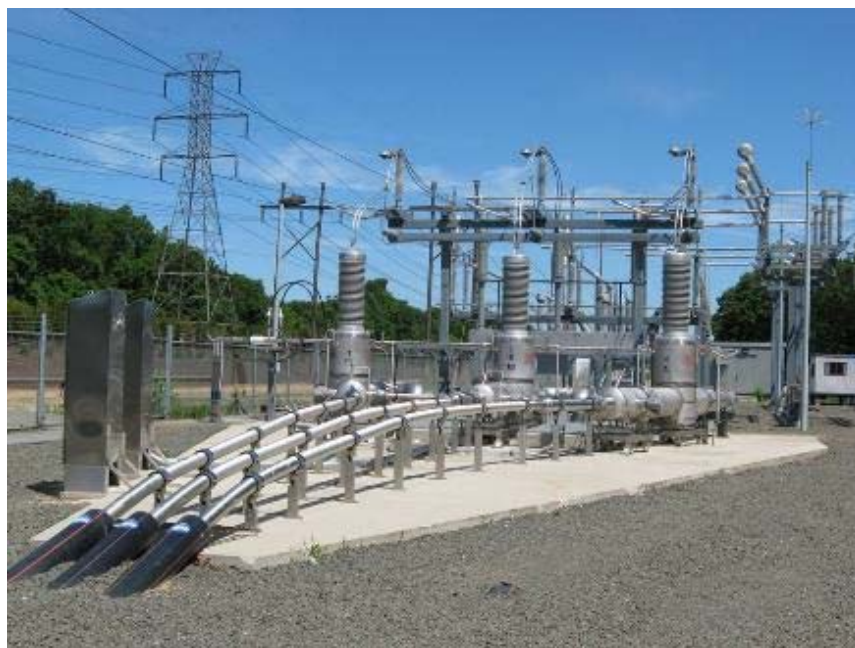
圖 11 Long Island 電力認證電纜 at Holbrook Substation
