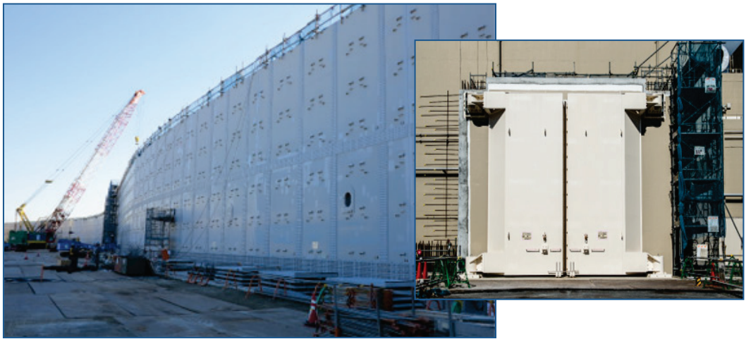
圖十八 浜岡核能電廠 22 公尺海嘯牆及水密門改善
