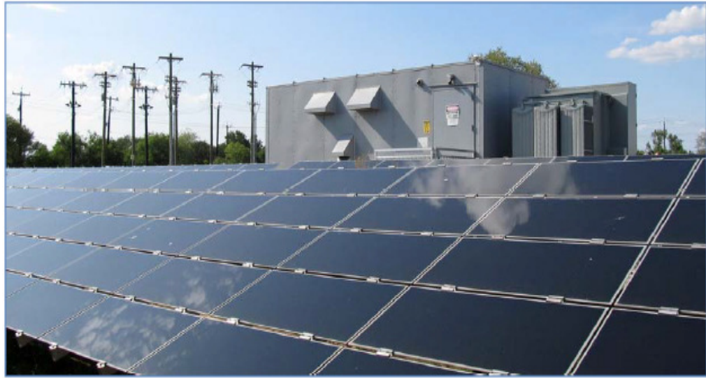
圖 41 太陽光電模組、電力站、電業饋線設備
