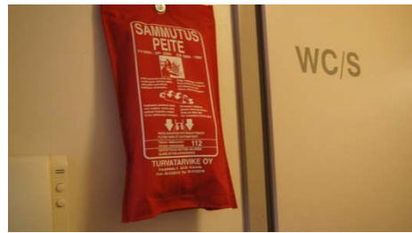
消防設備—防煙面罩、逃生路線
