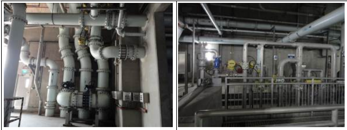
圖 17 樟宜廠 DTSS 主抽水站相關管線及設施
