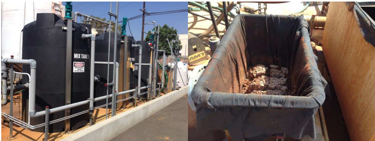
左圖為加藥混合槽，右圖為污泥槽及污泥餅
