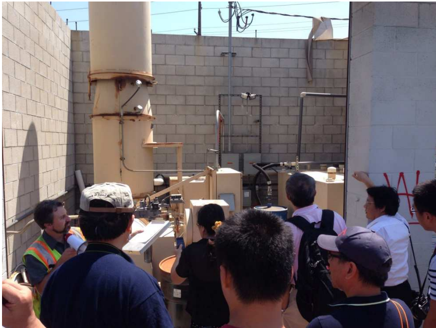
圖 3.8 本污染場址處理設施包含油氣燃燒及汽油回收設備
