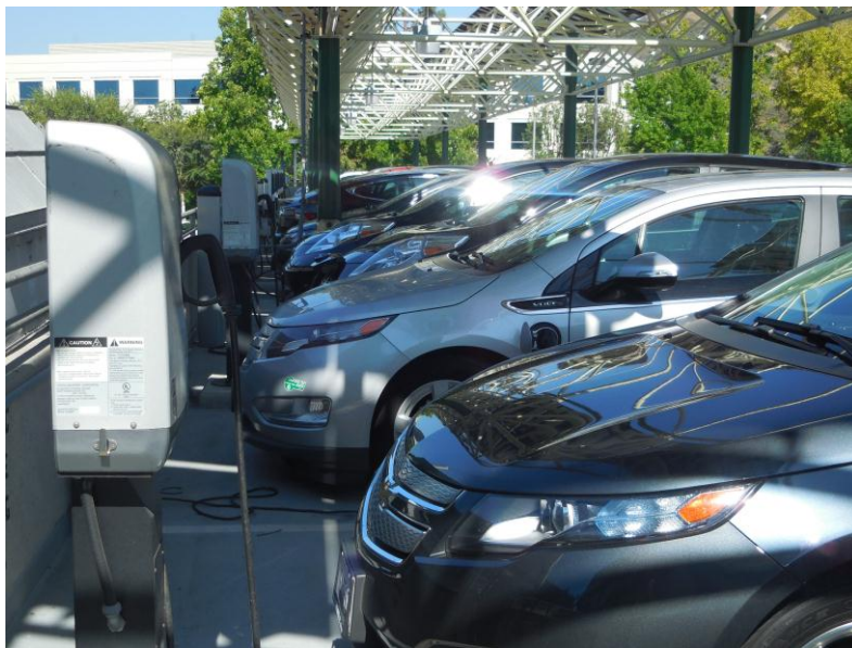
圖 59、加州南岸空氣品質管理局戶外電動車專用停車場
