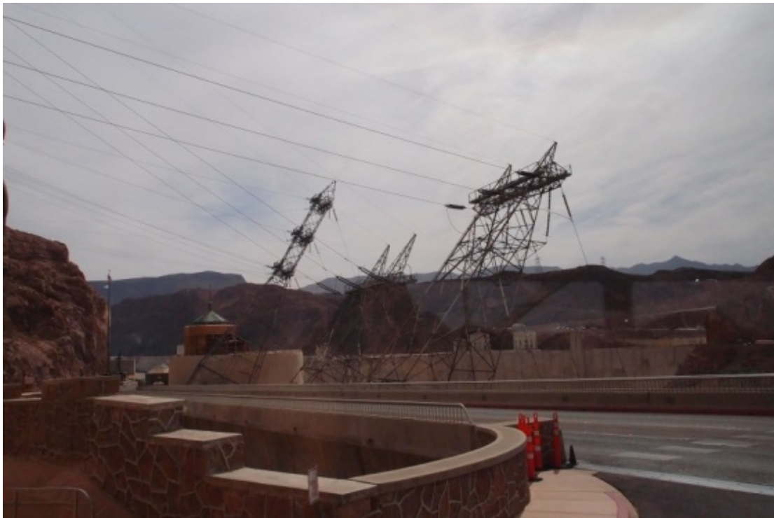
傾斜輸配電塔
