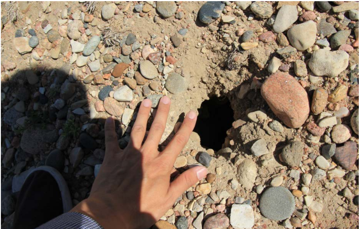
在Pueblo壩頂發現的小洞，據壩務員人員表示此洞已存在數年 研判為小動物所掘挖的淺層孔洞，並不影響大壩安全
