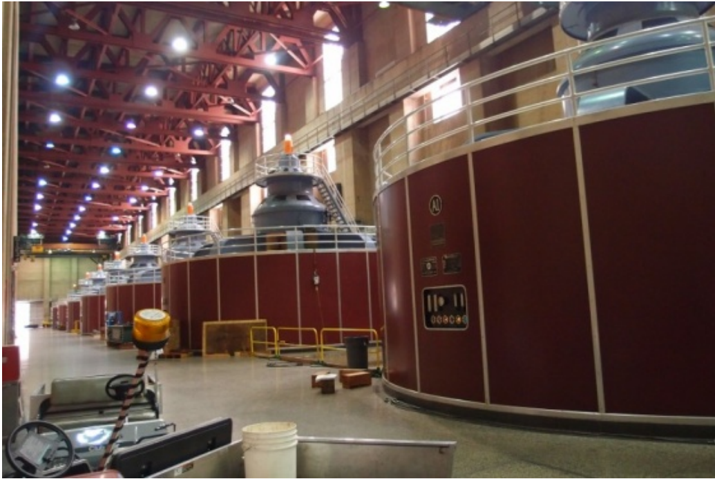
左壩基側發電機組
