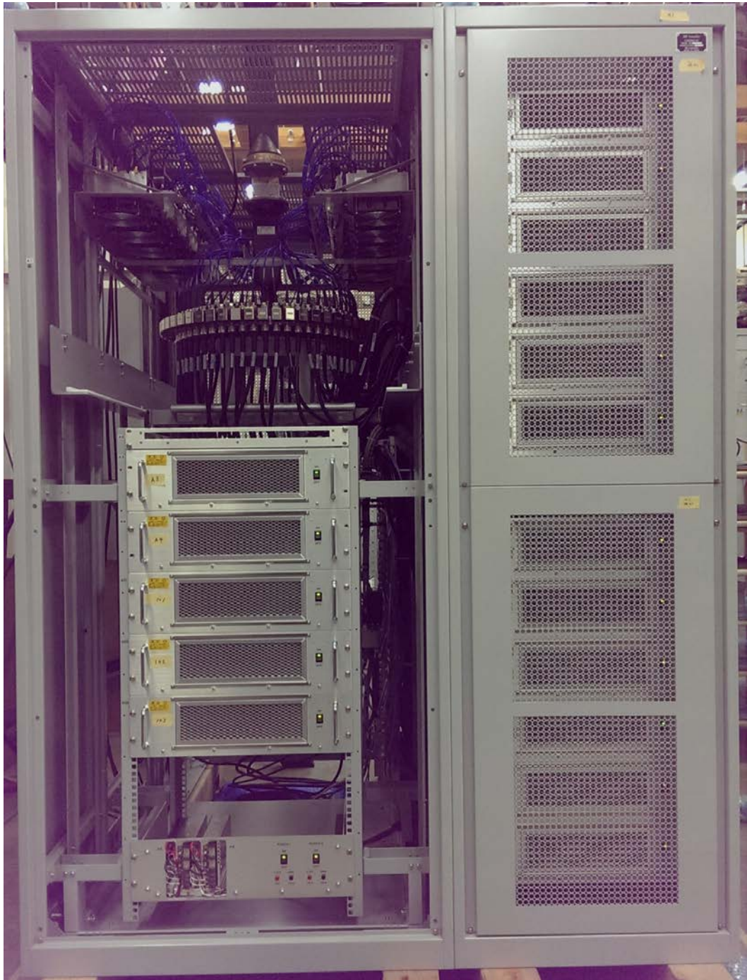
圖 2.16 PSR TX 實機照片
