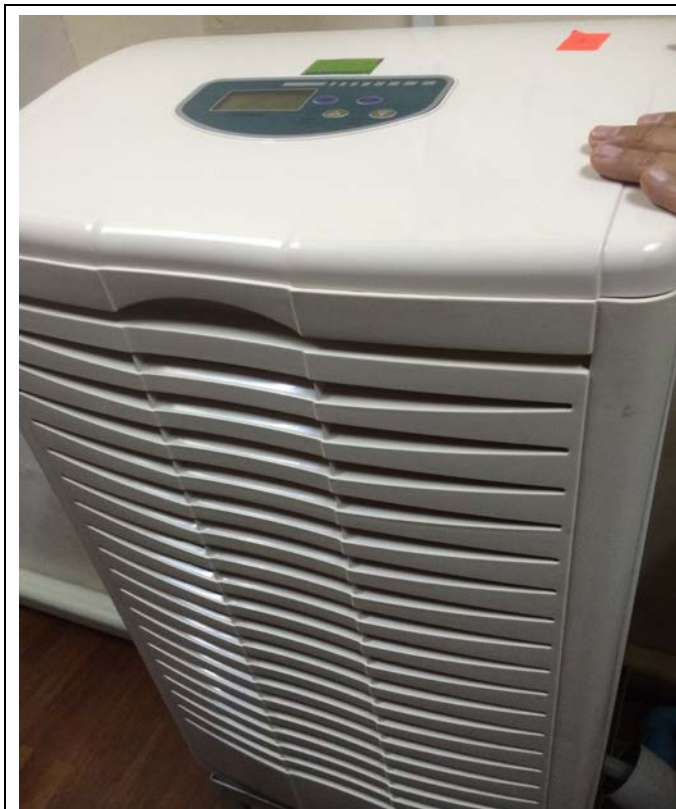
檔案庫房之除濕設備
