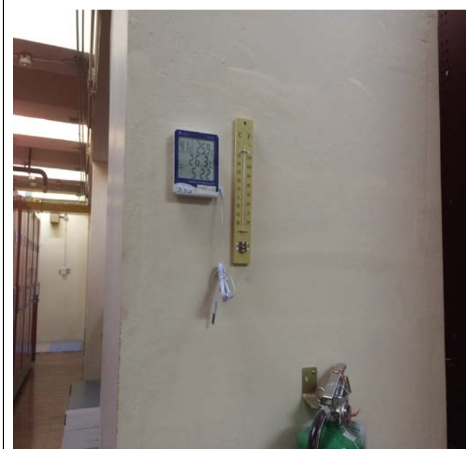
檔案庫房之空調及溫濕度監控
