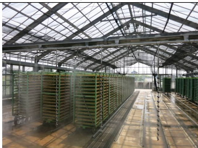
圖 12、綠化場自動灑水設備。
