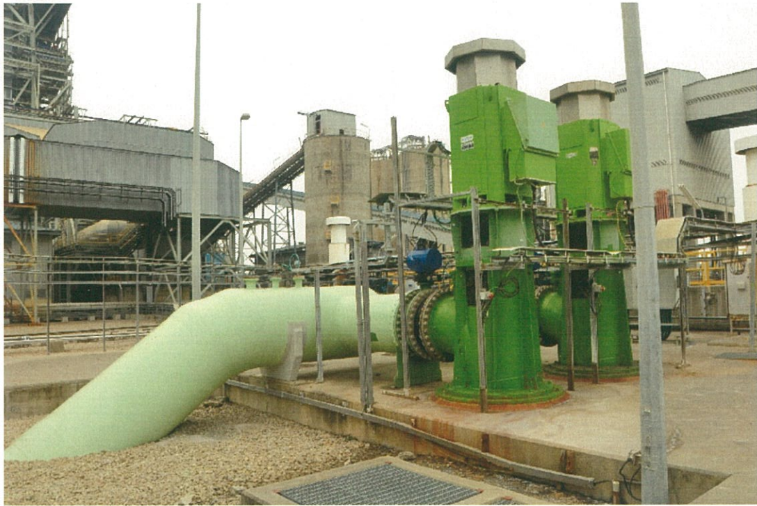
海水法脫硫現場設備(海水供給泵)見習
