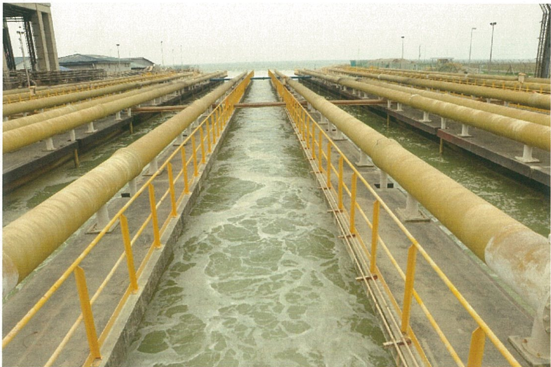
海水法脫硫現場設備(曝氣池)見習
