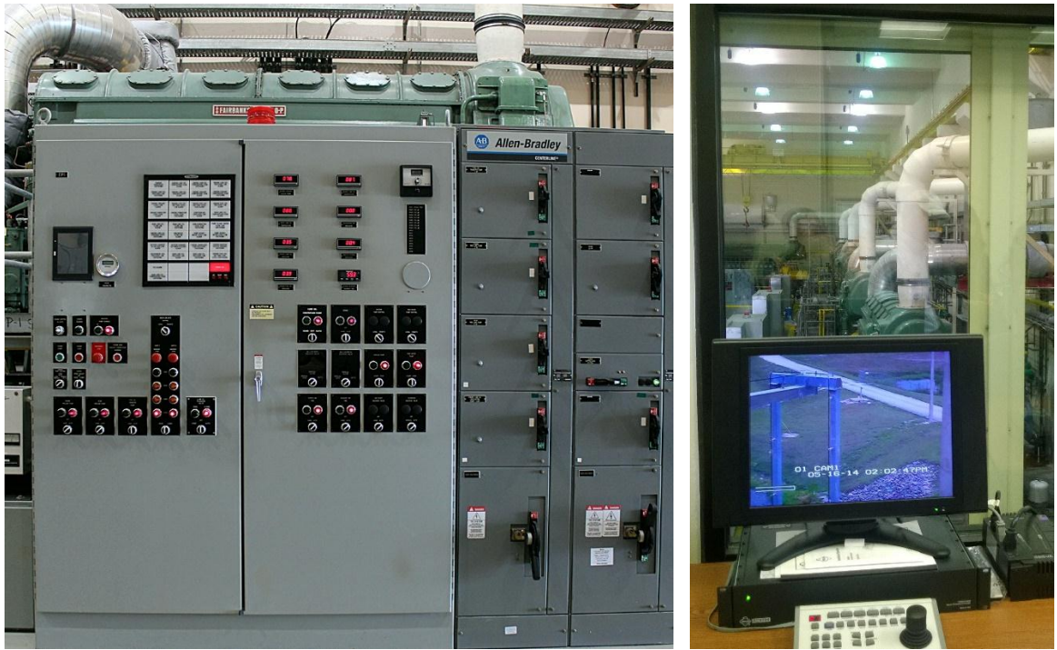
圖 29 抽水站內控制調整及監控之儀器設備
