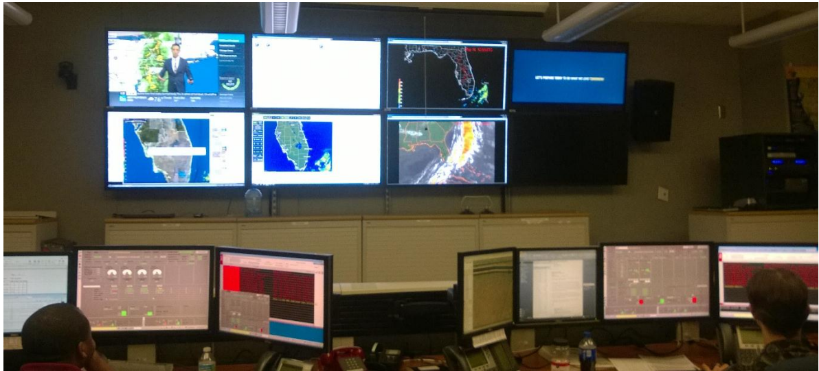
圖 26 南佛羅里達水管理局之河川流量監測及閘門控制系統
