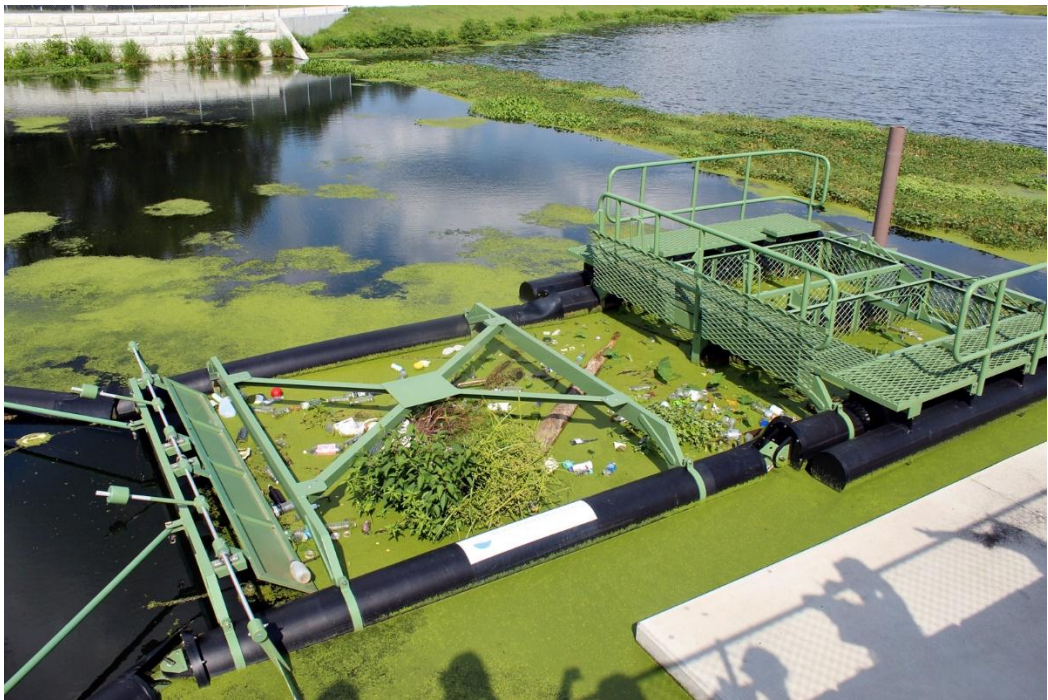
圖 15 沉砂池出口所設置之垃圾蒐集器
