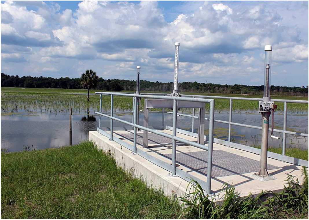
圖 14 濕地放流口控制出水量之閘門
