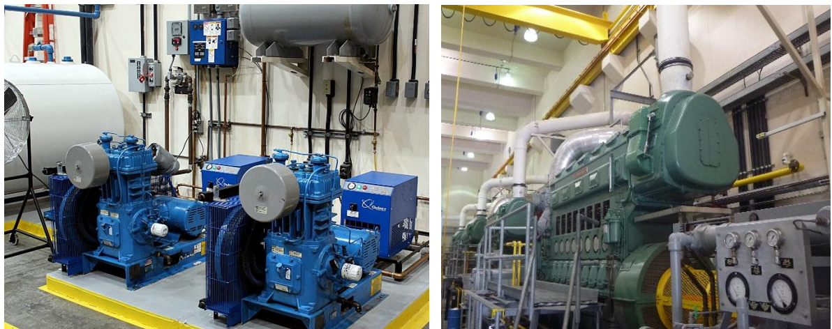
圖 28 大型抽水站內以船舶引擎改裝之抽水馬達
