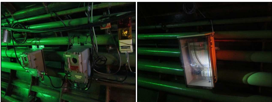
圖 11、有害氣體偵測及通訊設備
