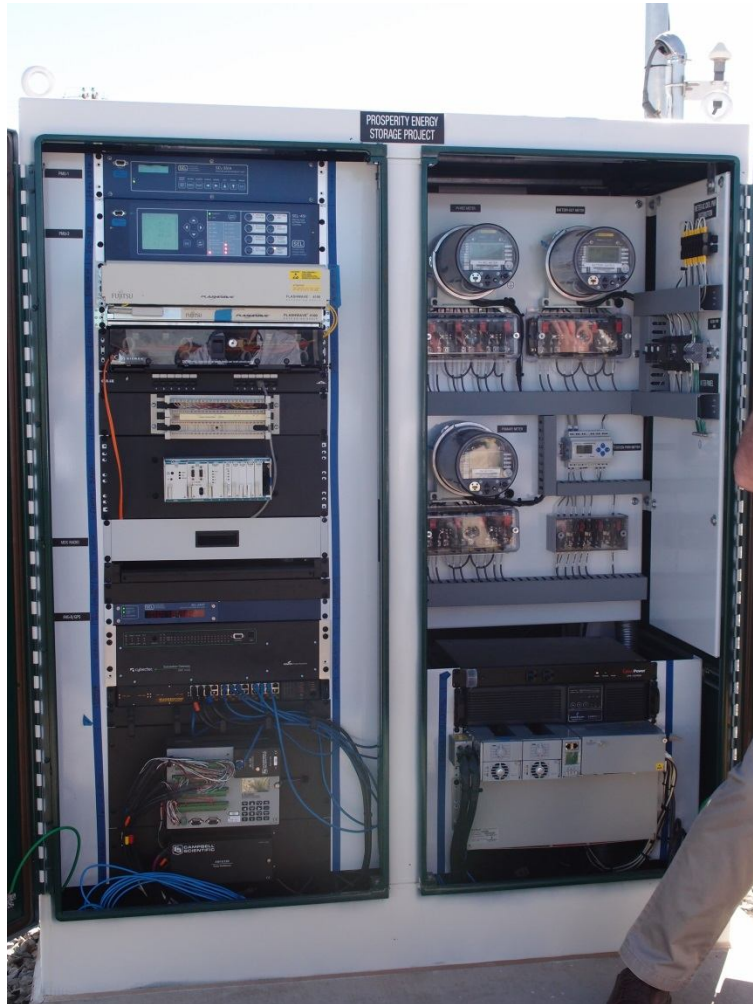
圖 4.18、智慧型電網主要的通訊及控制主機
