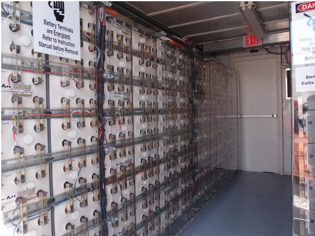
圖 4.19、智慧型電網的儲能系統內部，基本上為鉛蓄電池(LEAD-ACID BATTERY)堆
