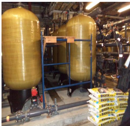
海水處理沙濾系統
