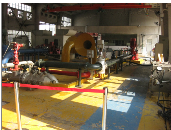
圖 14 消防水泵測試設備
