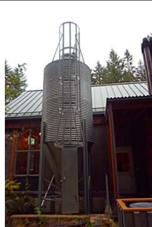
生質能源設備外觀
