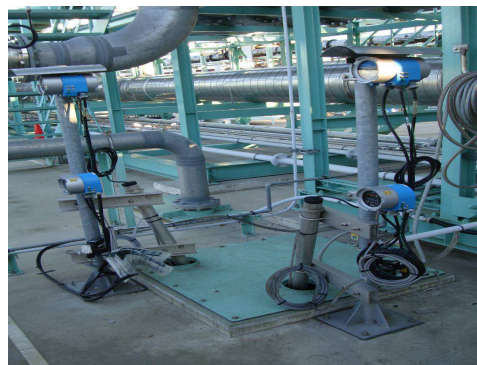
圖 45 BDN 硝化槽之控制設備
