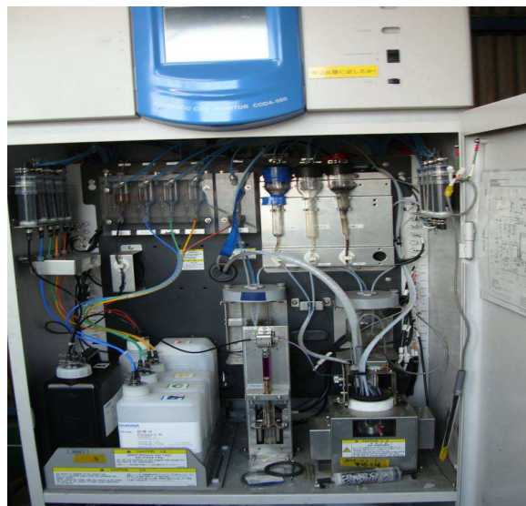
圖 22 化學需氧量自動監測儀及內部
