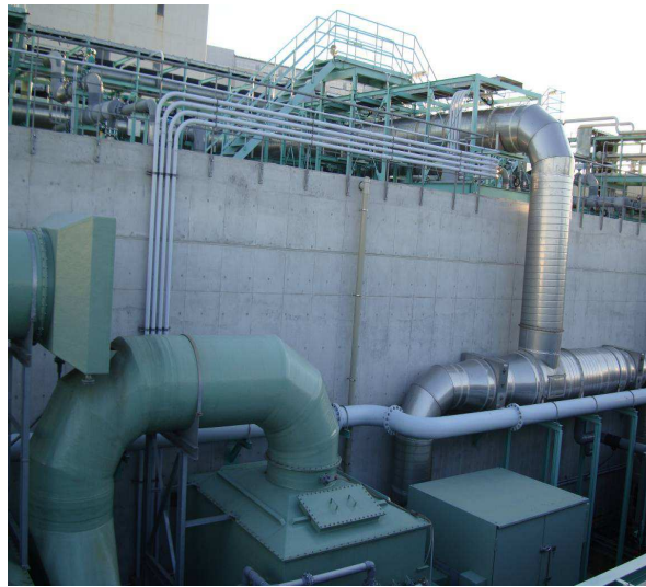
圖 44 BDN 處理設備及臭氣處理裝置
