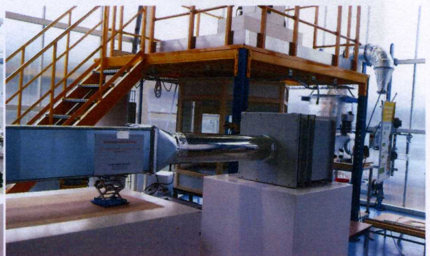
風管空氣品質量測設備 2
