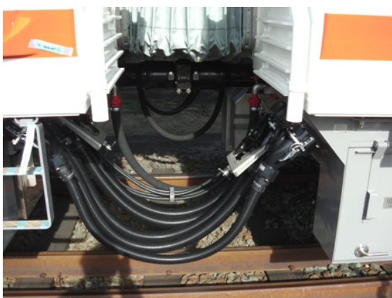
圖107 車間108芯跳線確認
