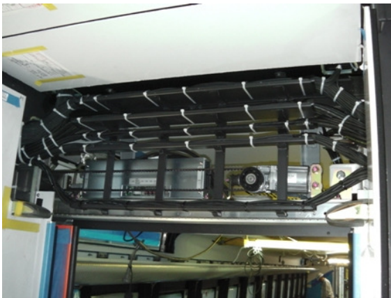
圖19 通道門區配線檢視
