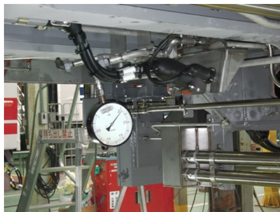
圖60 車體管路洩漏檢查
