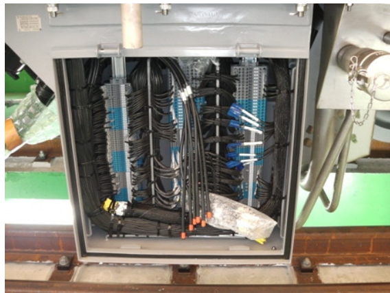
圖50 車下108芯配電盤接線
