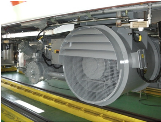
圖53 TEP車主變壓器配置
