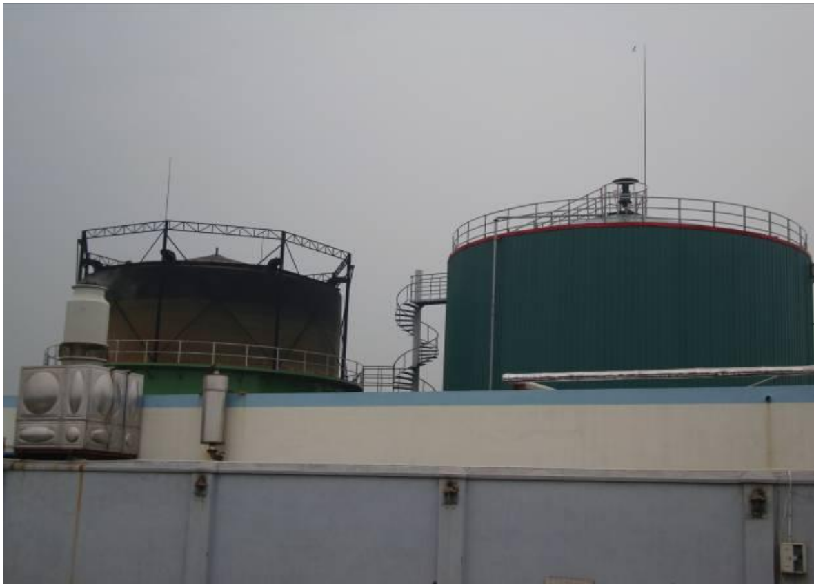
圖 27 發電機尾氣燃燒單元、貯氣槽、厭氧消化槽
