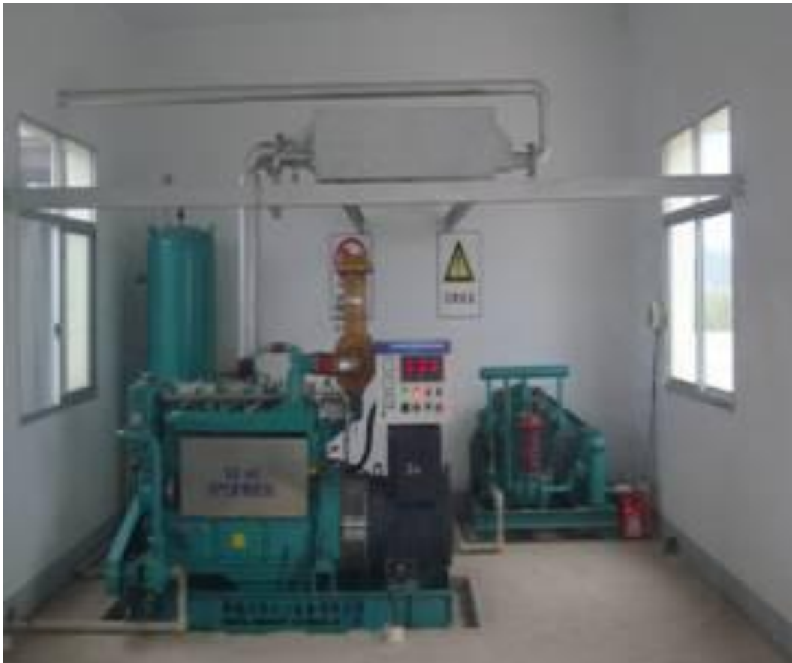
圖 29 82 kw 沼氣發電機組
