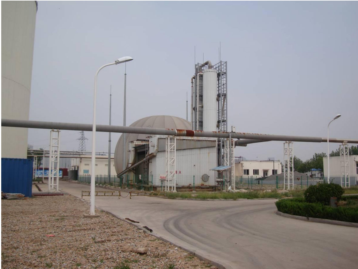
圖 13 沼氣生物純化及雙膜式貯氣槽
