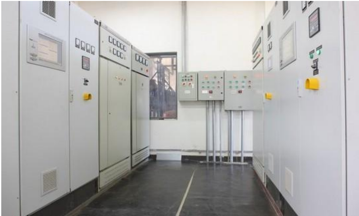
圖 6 沼氣發電機組電氣設施
