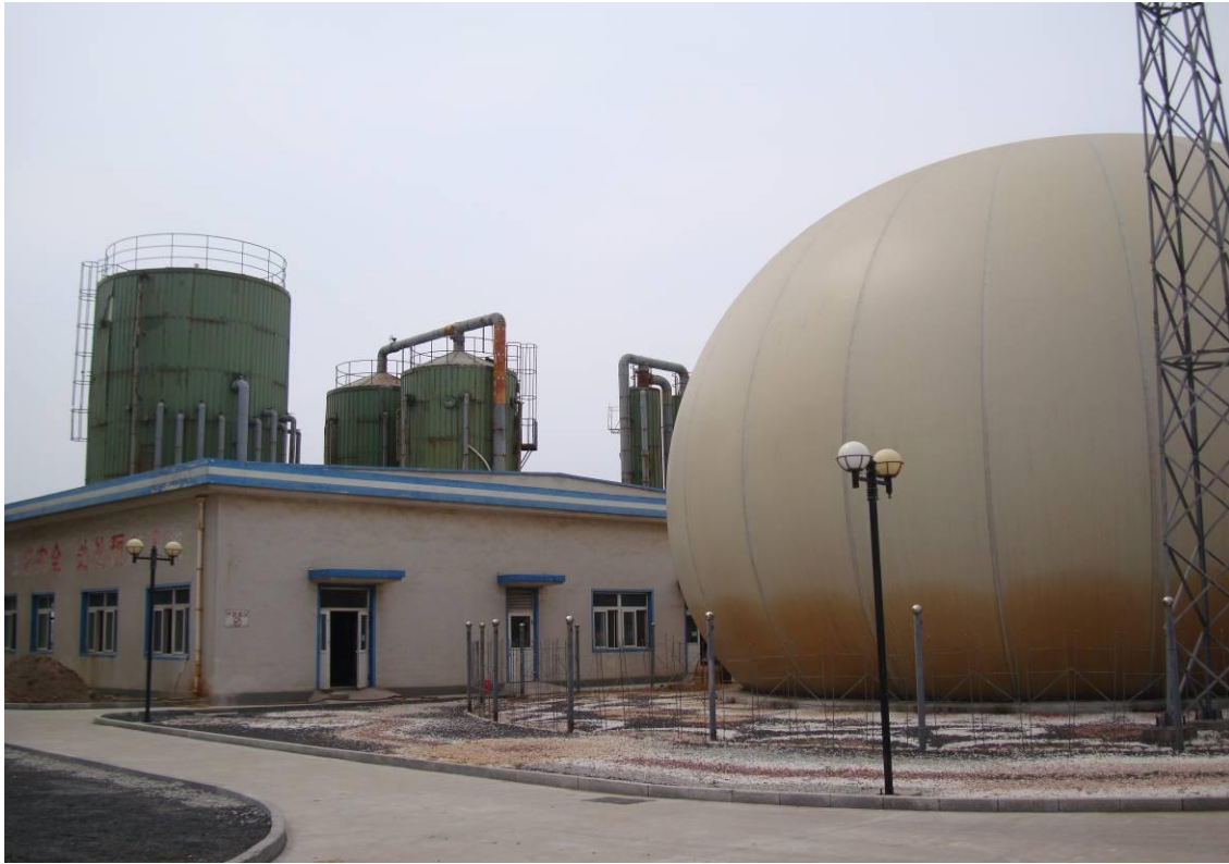
圖 5 生物脫硫塔及雙膜式甲烷貯氣槽
