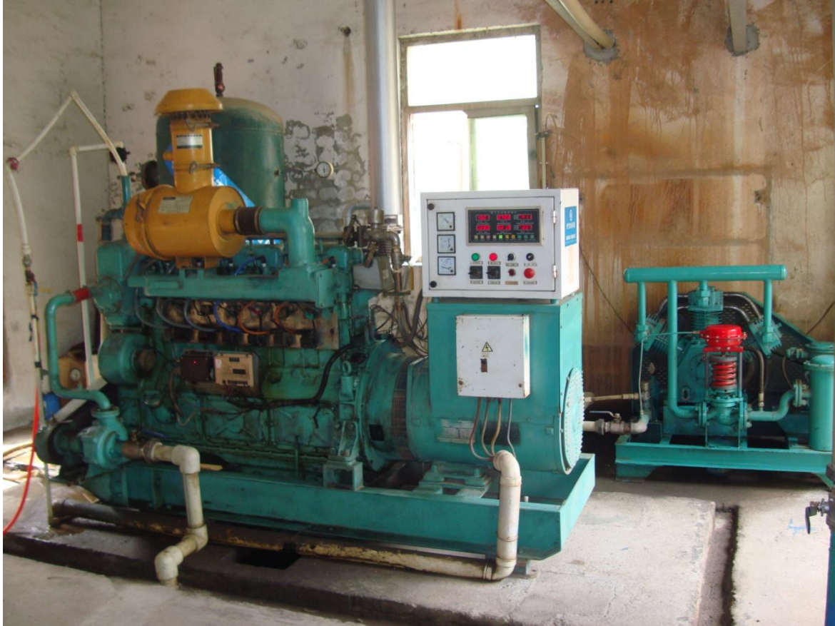
圖 36 200 kw 發電機組
