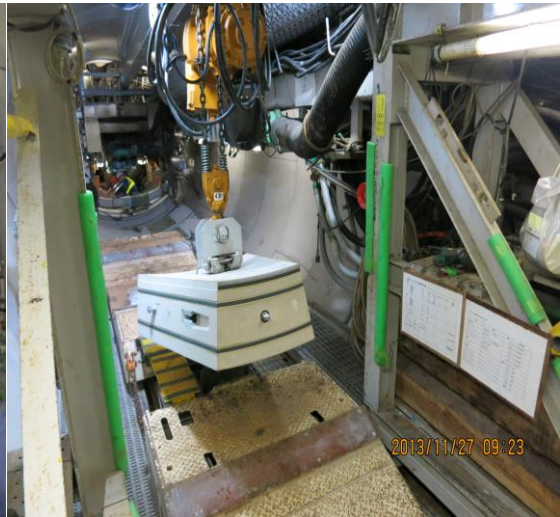
圖 25 鋼環片吊裝機
