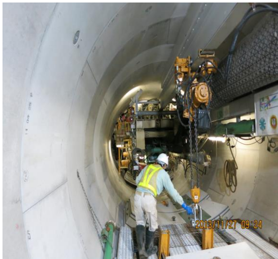
圖 26 鋼環片吊裝機
