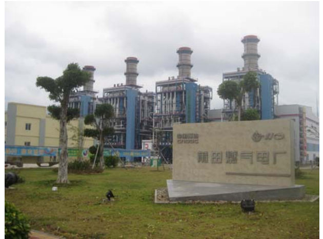
莆田電廠#1~4 機餘熱鍋爐外觀
