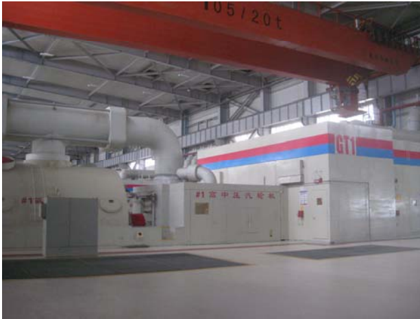
莆田電廠機組廠房內部
