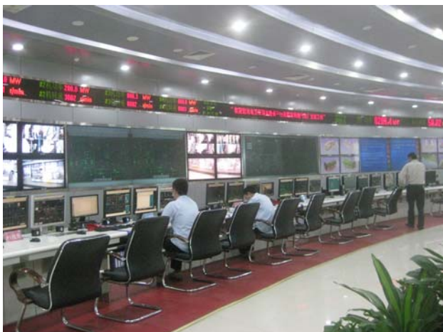
莆田電廠中控室
