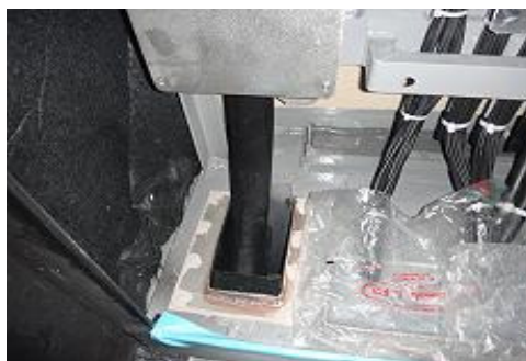
圖7高壓電纜導槽
