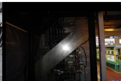
圖8高壓電纜導槽
