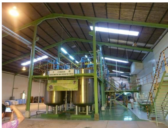
液肥工廠中之有機液肥不鏽鋼發酵槽。
