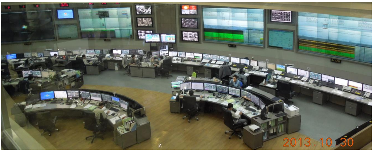
中央控制室(4部機)
