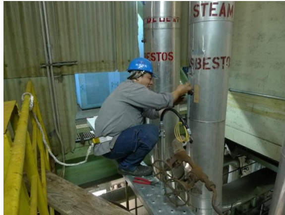
4. 現場各式傳送器安裝。
