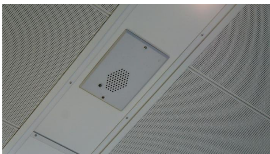
圖 38 電扶梯上方音鳴器可提醒盲人已接進電扶梯
