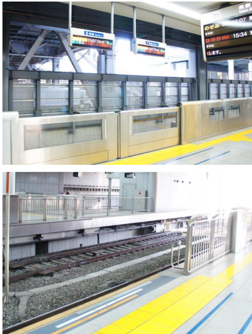
圖 6 品川車站月台防護設施照片
