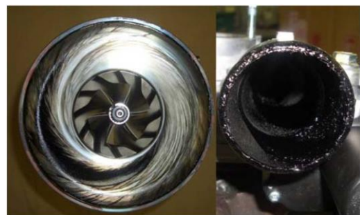
圖 21 有積污的渦輪壓縮機: 左為擴散器, 右為壓縮機出口
