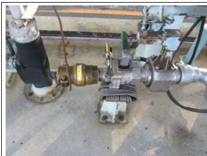
灌裝泵島-管線接頭
