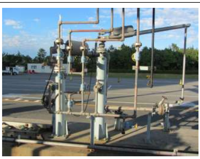
灌裝泵島-臭劑管線
