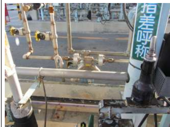
灌裝泵島-臭劑管線
