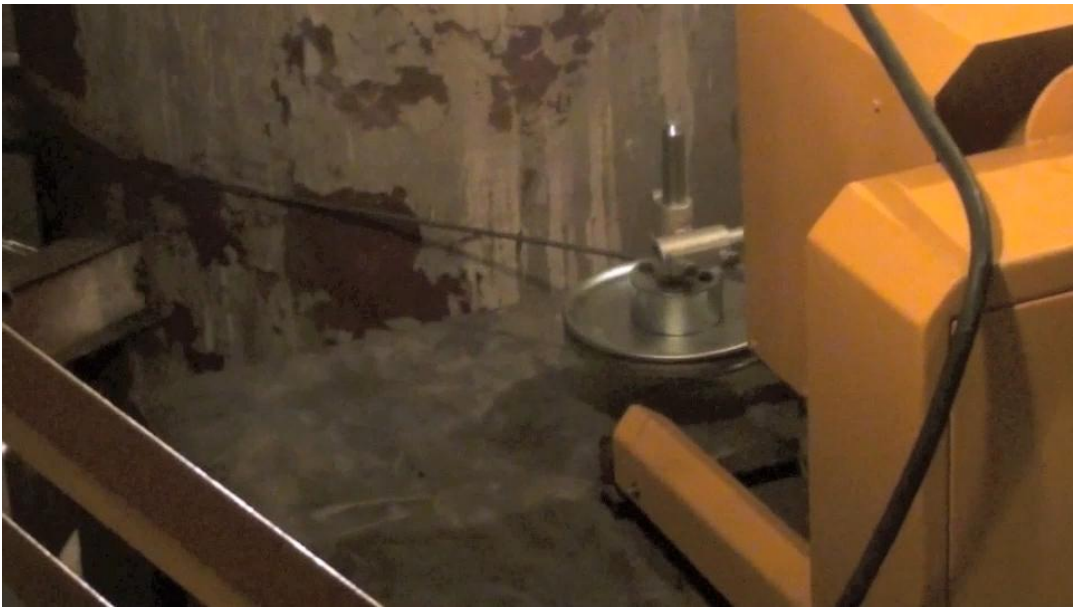
圖五十七、西班牙 JOSÉ CABRERA NPP 除役_NSSS 拆解_大型桶槽切割
