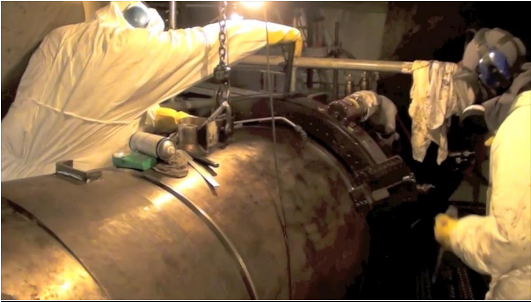
圖五十四、西班牙 JOSÉ CABRERA NPP 除役_NSSS 拆解_大管徑管路切割(一)
