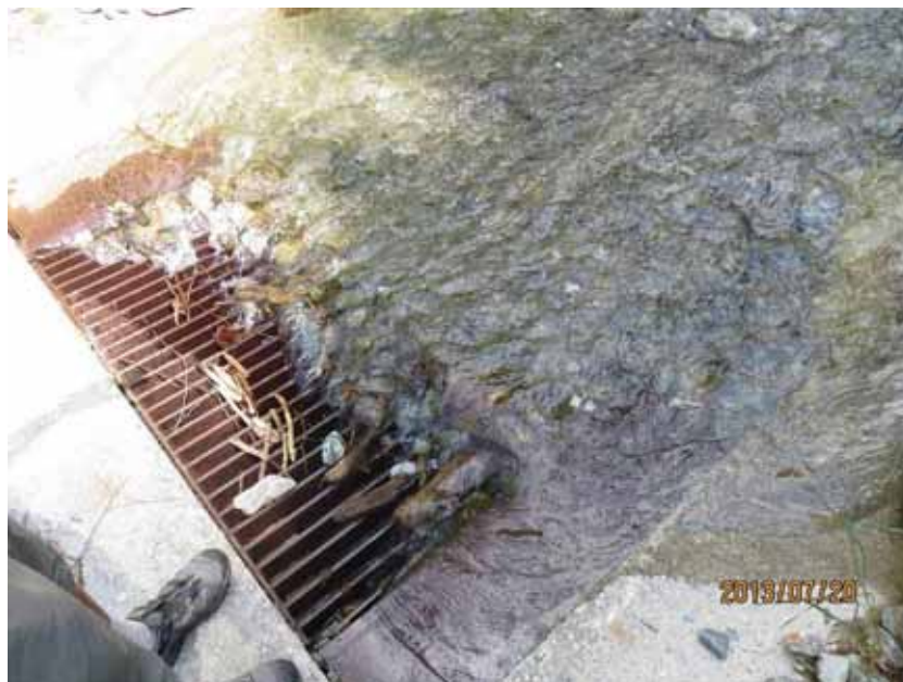
相片 3-86 在尋常水位時，水流流到地下涵管以利民眾交通。大水時整體河道均為通洪(土石流)斷面，道路封閉禁止民眾通行，避免造成傷亡
