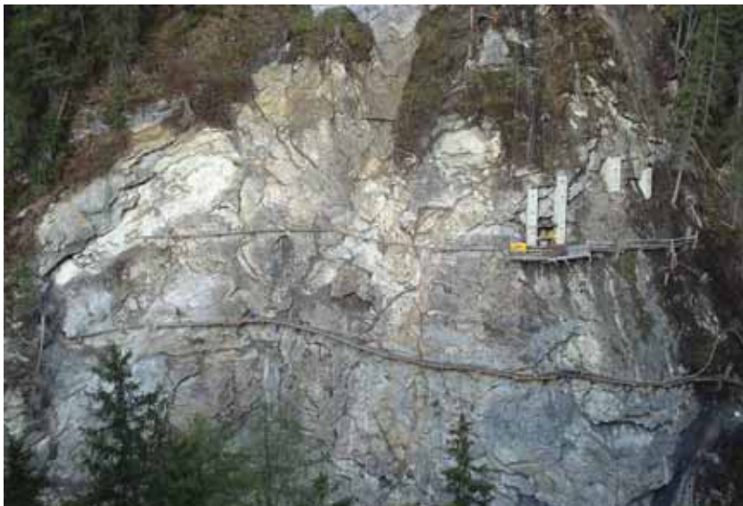
相片3-103 於陡峭山壁上施設防落石措施及工作平台(WLV提供)
