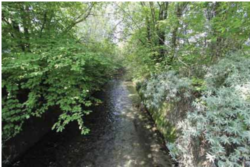
相片 3-29 非汛期的通水渠道
