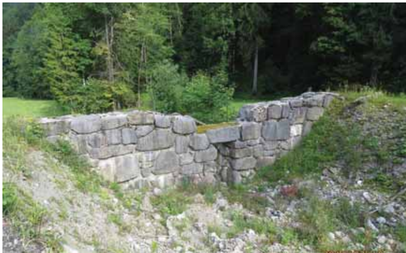
相片 3-65 小型滯洪功能的 Dosing Dam
