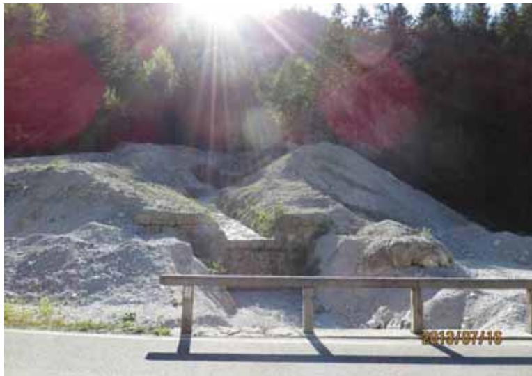
相片 3-56 另一座公路橋上往上游側拍攝系列式攔砂壩(斷面不足造成土砂淤積於兩側)
