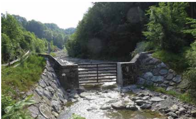
相片 3-64 攔阻土砂之 Breaking Dam
