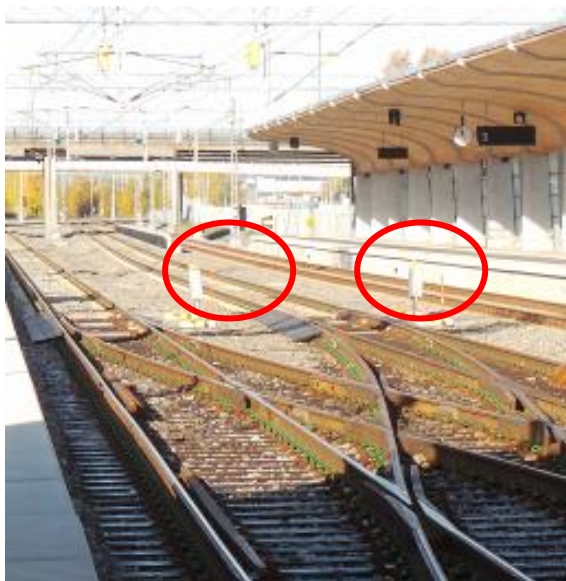
圖 64 Level-2 電動轉轍就地控制設備
