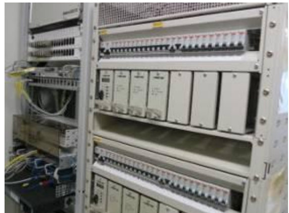
圖 61 Level-2 機房光傳輸模組
