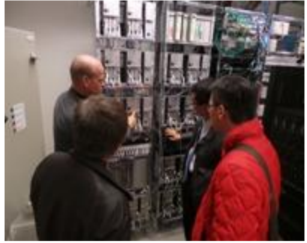
參訪斯德歌爾摩中央車站號誌設備建置狀況
