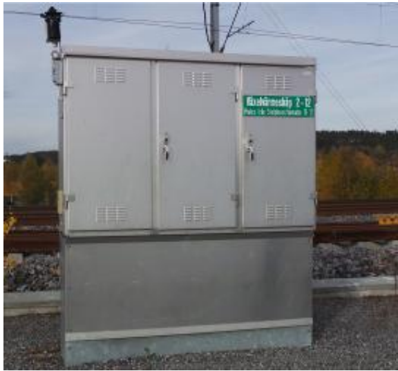
圖 62 Level-2 軌旁號誌箱
