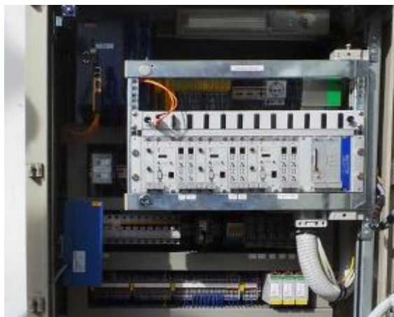
圖 33、簡易型電子聯鎖設備
