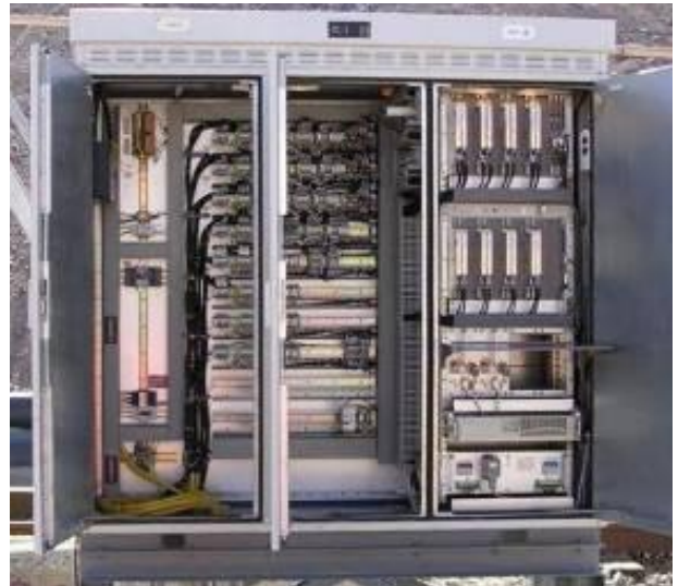
圖 63 Level-2 軌旁號誌箱內部設備
