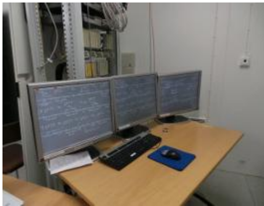
圖 60 Level-2 機房維護終端機
