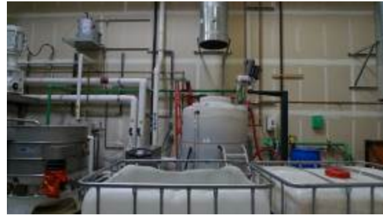
蟲生線蟲的繁殖可利用處理有機廢棄物的大型發酵槽進行(圖中的儲存統內為已經發酵完成之產物)
