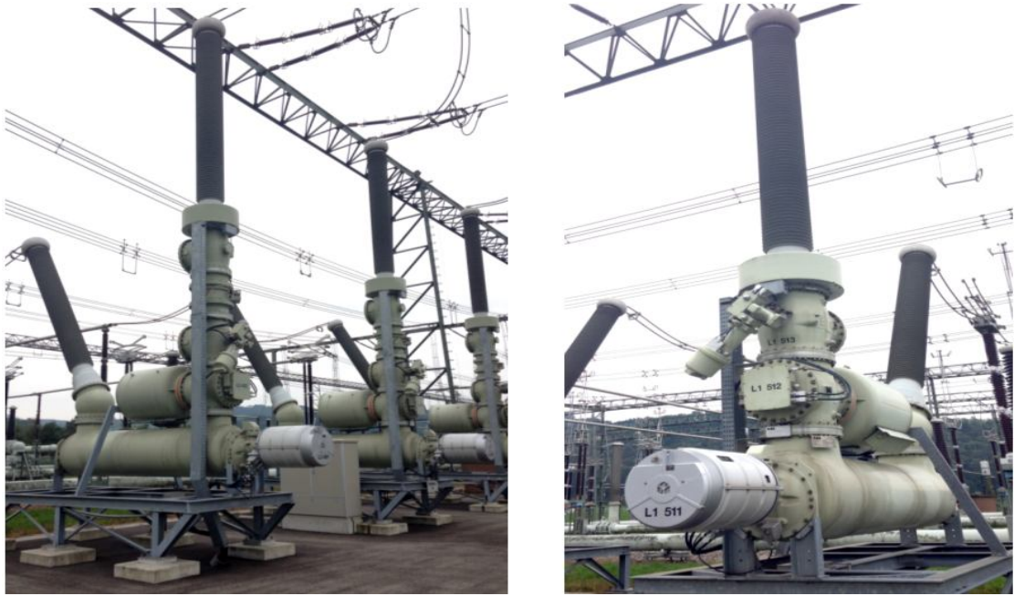
圖 23、Laufenburg 變電所之 GIS(左邊有配置 NCIT)
