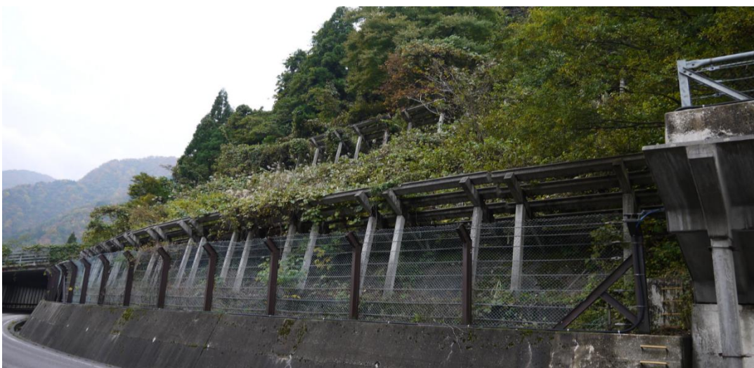
圖 3 柔性防護柵搭配剛性落石棚
