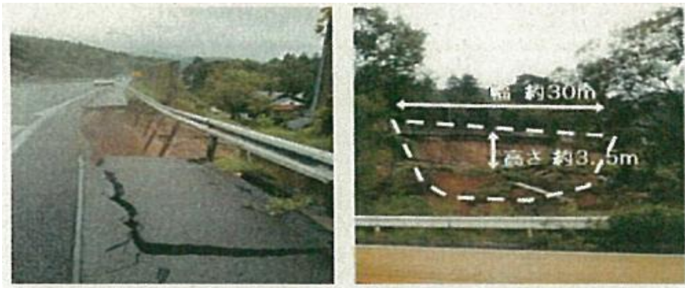
圖 16 路基掏空情形
