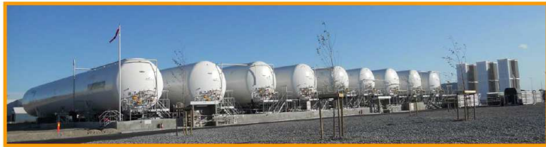
LNG Liquefaction & Infrastructure
