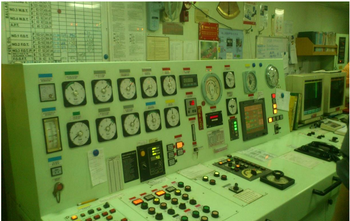
圖 4 集中控制室的遠端儀表監控裝置及船舶機艙自動化系統。
